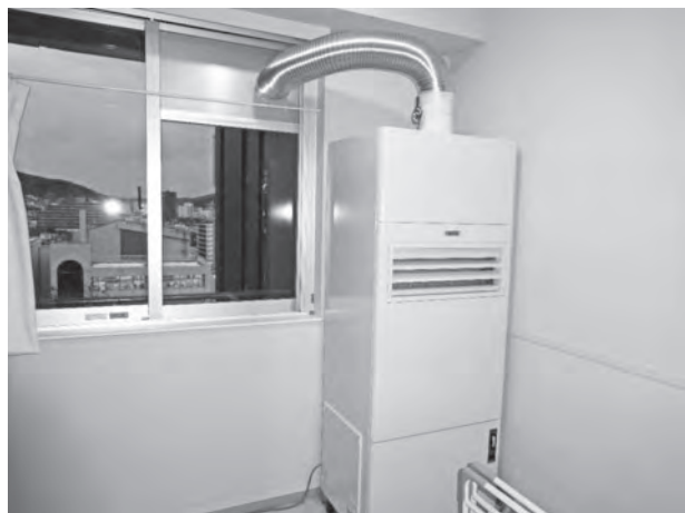
写真4：排気フィルターユニット
